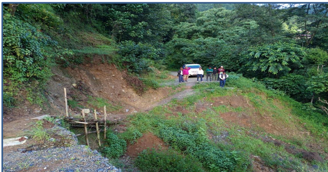
Road damage at Vedhikhori Hugdishir बराहकोट बरेङ सडक खण्ड (भेडिखोर पहिरो)
